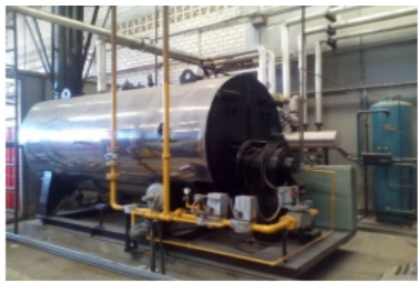
FOTOGRAFIA 3. CALDERA DE 80 BHP*
