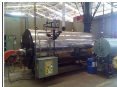
FOTOGRAFIA 4. CALDERA DE 150 BHP*
