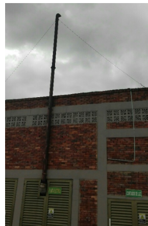
FOTOGRAFIA 6. DUCTO DE LA PLANTA ELECTRICA
