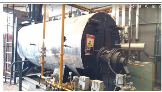
FOTO No. 4 CALDERA DE 80 BHP
