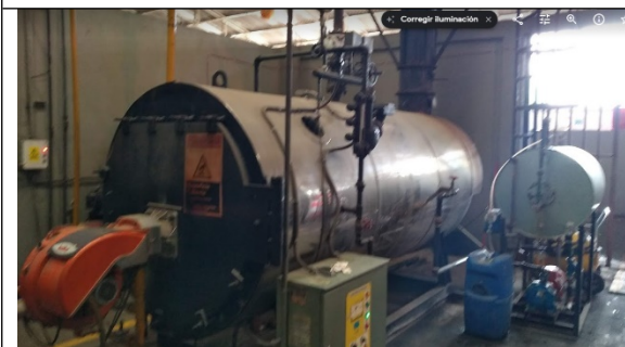
FOTO No. 3 CALDERA DE 150 BHP
